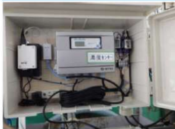
濁度センサー部設置例
