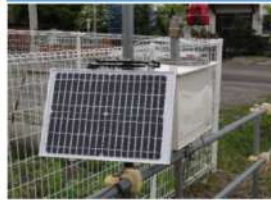
車両感知設置状況
